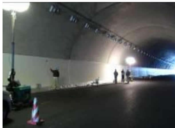
三遠南信自動車道 川路トンネル 視線誘導塗装
